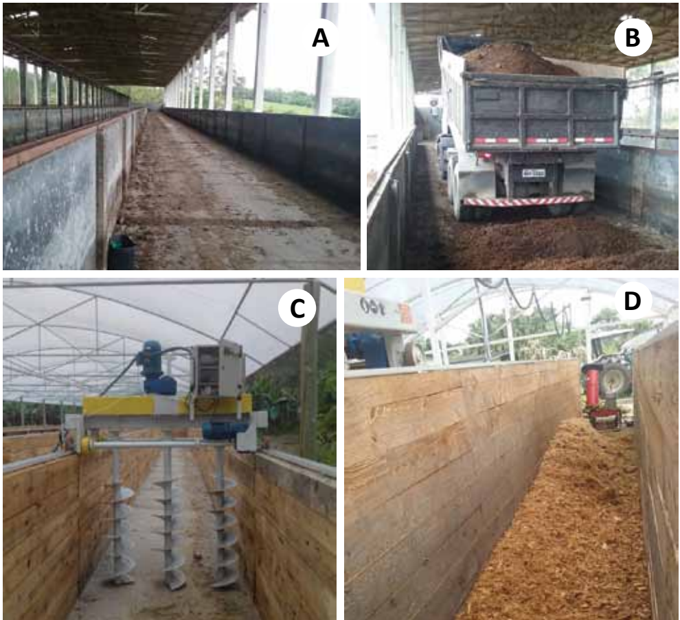
Figura 4. Instalações de sistema automatizado de compostagem com capacidade de locomoção de máquinas e caminhões (A e B) e de menor dimensionamento com possibilidade de manejos de alocação e retirada de materiais com microtratores e carrinhos de mão (C e D)
